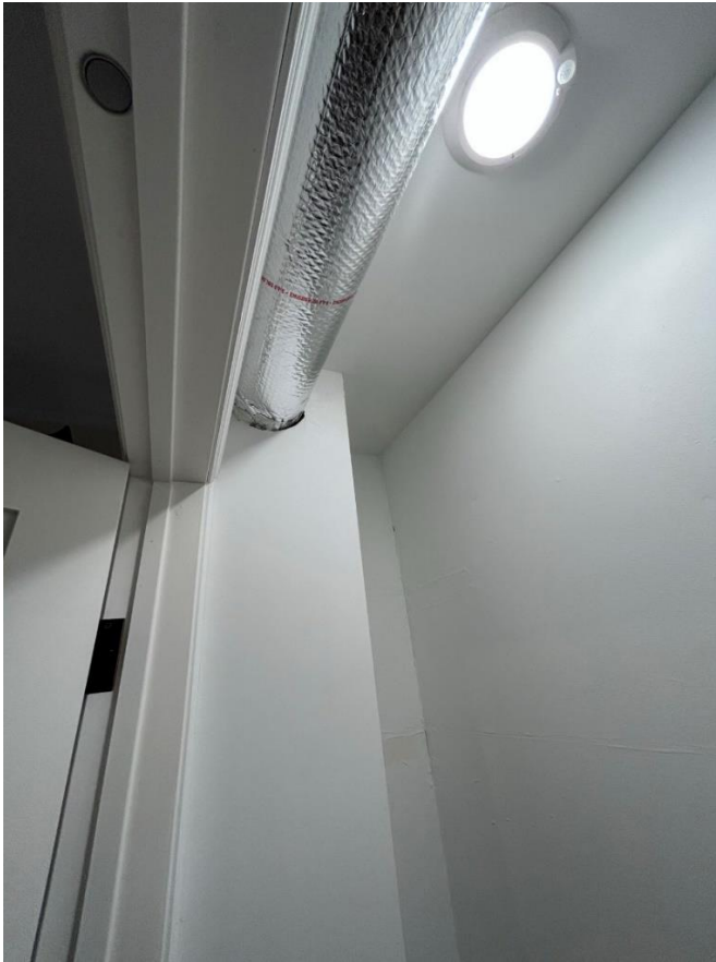
Figur 18: Kanaldragning från vind genom inbyggd garderob till nedervånings vardagsrum.
