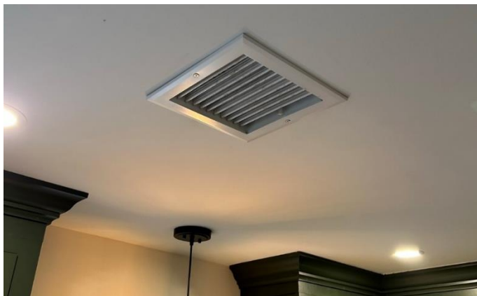
Figur 21: Tilluftsventil kök, nedervåning.
