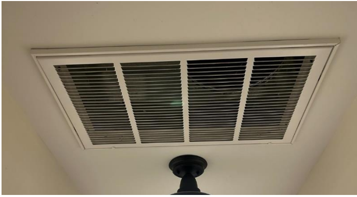
Figur 28: Frånluftsgaller i tak, korridor utanför sovrum 3 och 4.
