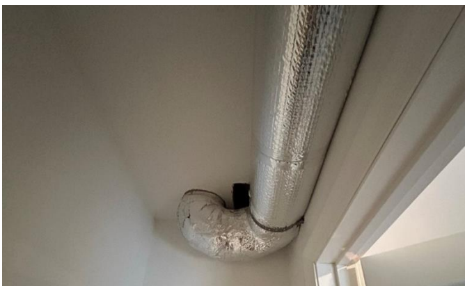
Figur 17: Kanaldragning från vind genom inbyggd garderob till nedervånings vardagsrum.
