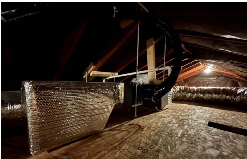
Figur 26: Kanalansluten luftbehandlare på nedervåningens vind.
