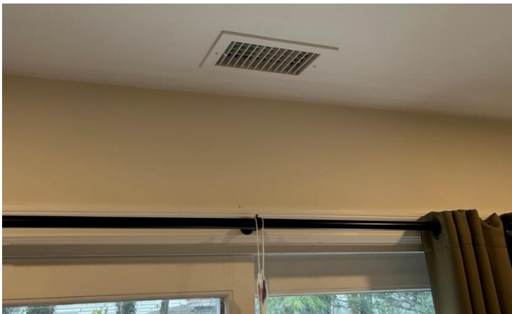
Figur 24: Tilluftsventil allrum, nedervåning.
