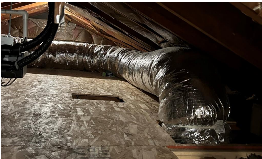
Figur 27: Frånluftskanal dragning på vinden.
