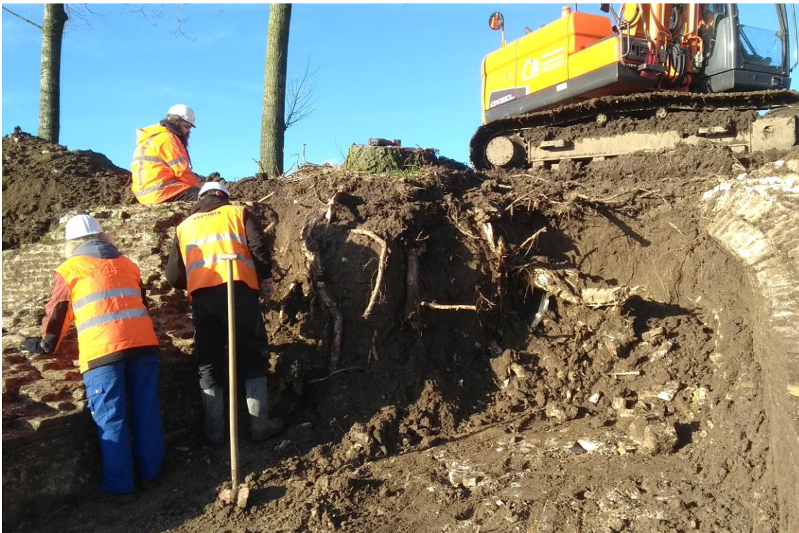
Afbeelding 18: In de sluisgang heeft tot kort voor het onderzoek nog een grote populier gestaan, waarvan het wortelstelsel deels in de sluiswand was gegroeid. Foto: Vestigia 2023.
