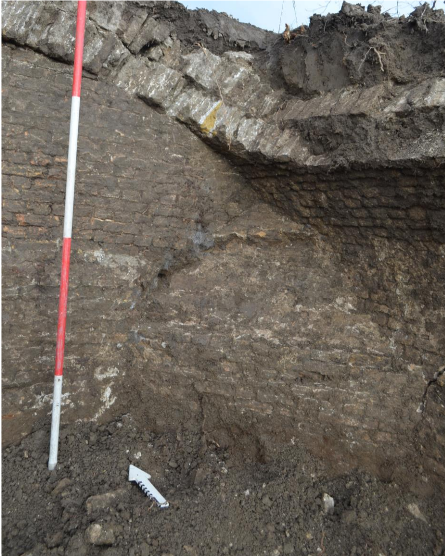
Afbeelding 16: De koepelvormige steunbeer in de sluisgang, op de overgang van de sluiswand (rechts) en de dwarswand (links). Foto: Vestigia 2023.
