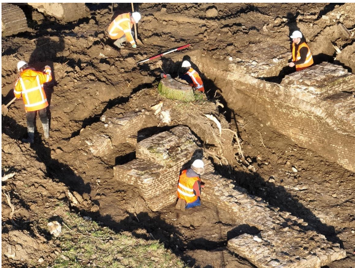
Afbeelding 6: Het veldteam aan het werk bij het vrijleggen van de sluisconstructie van 'De Nieuwe Sluis' Foto: BVL de Winter.
