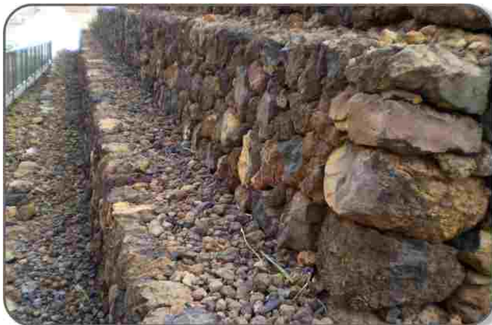
Piramida broj 5, kombinacija vulkanskog kamena iste dužine na ivicama stepenica, vulkanskog šljunka na stepenicama i obrađenog vulkanskog kamena s obje strane na ivicama. Očigledan je planski pristup gradnji ovog objekta.
